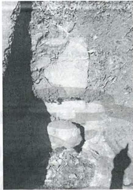
Imagen 1 Tragante socavado, dañado y obstruido
