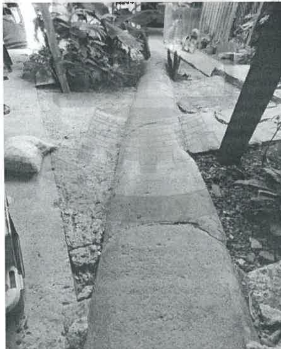
Imagen 10 Tubería de Concreto de 18 pulgadas
