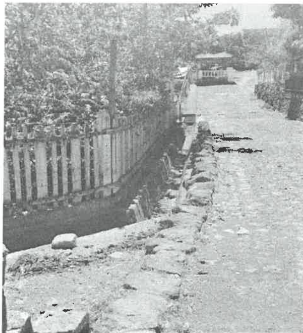
Imagen 4 Aguas provenientes de dique
