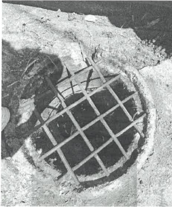
Imagen 11 Pozo de registro Pluvial / Sanitario
