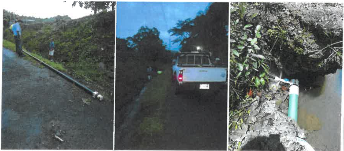
Daños a tubería de AyA
