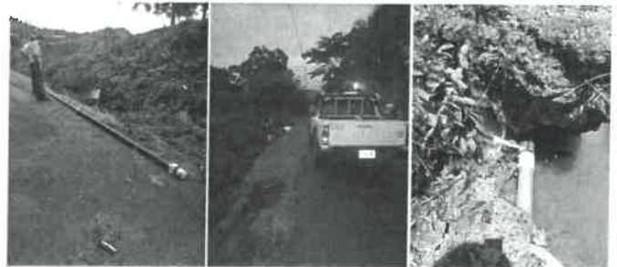
Daños a tubería de AyA
