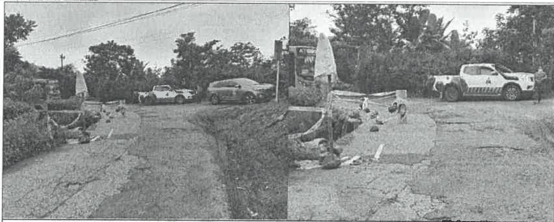
Figura 3: deslizamiento ocurrido en talud paralelo a la ruta cantonal que lleva a Estanquillo. Disparado por la verticalidad, mal manejo de aguas pluviales en la zona y ausencia de obras de contención.
