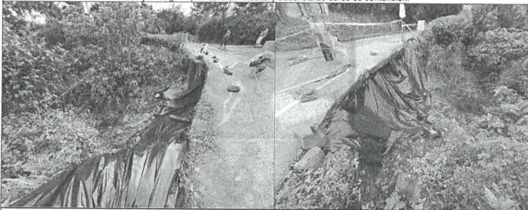
Figura 4: socavamiento de la ruta cantonal que lleva a Estanquillo, deslizamiento disparado por inadecuado manejo de aguas pluviales.
