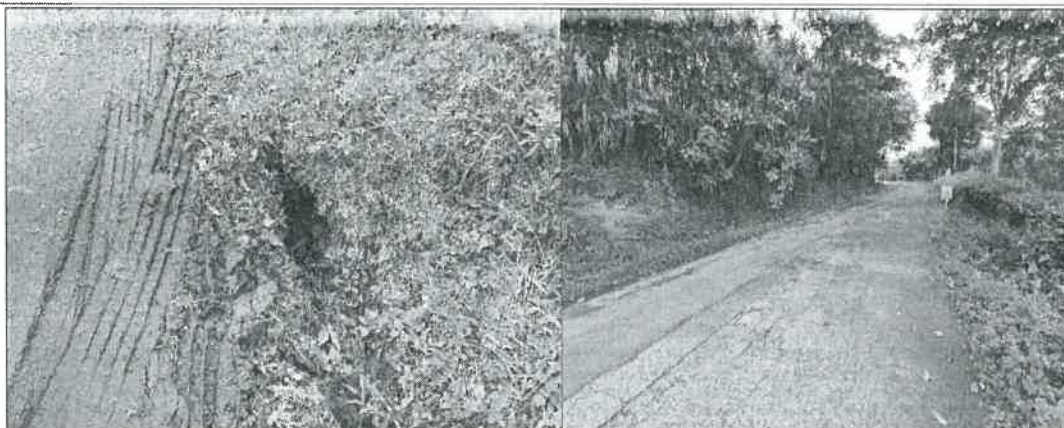
Figura 5: sistemas de manejo de aguas pluviales deficientes a lo largo de la ruta que lleva a Estanquillo.
