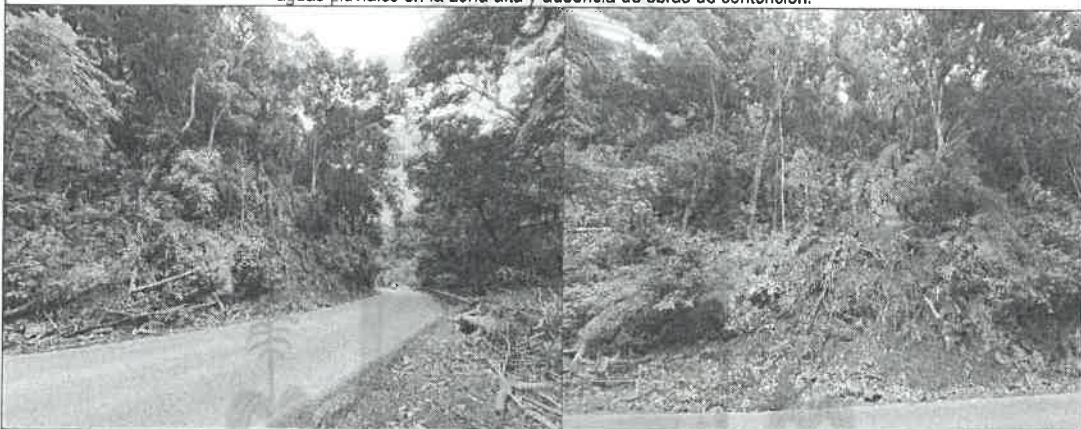
Figura 4: deslizamiento ocurrido en talud paralelo a la ruta nacional 135, punto 3. Disparado por la verticalidad, mal manejo de aguas pluviales en la zona alta y ausencia de obras de contención.
