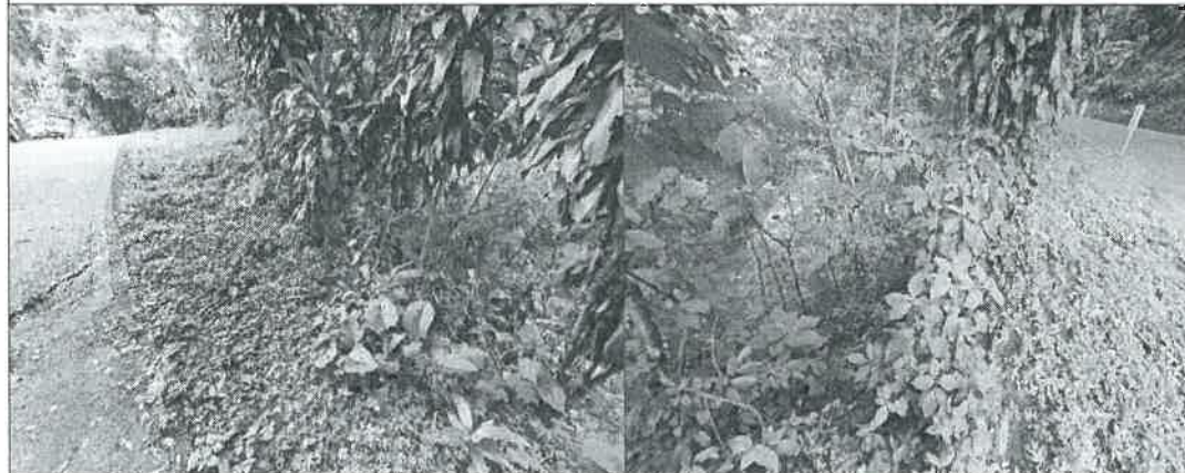
Figura 6: Ausencia de cunetas en ruta nacional 135, descarga de aguas pluviales hacia la zona de inestabilidad y deformación.
