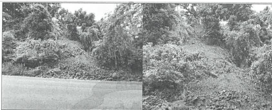
Figura 3: deslizamiento ocurrido en talud paralelo a la ruta nacional 135, punto 1. Disparado por la verticalidad, mal manejo de aguas pluviales en la zona alta y ausencia de obras de contención.
