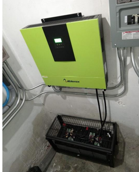
Foto #5 Sistema IPS, cajas de breaker, baterías Auditorio
